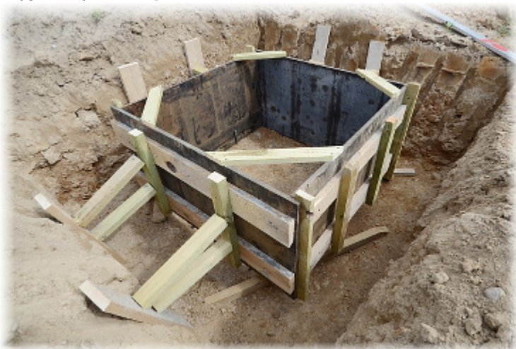
Zalany fundament masztu z zatopioną kotwą oraz założoną podstawą:
